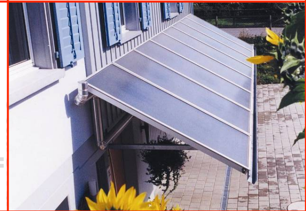
Kollektoranlage an Hausfassade © SSES
